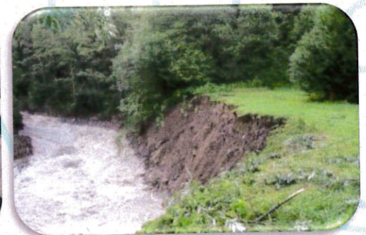
Erosion due à la crue de 2007 sur la Menoge
