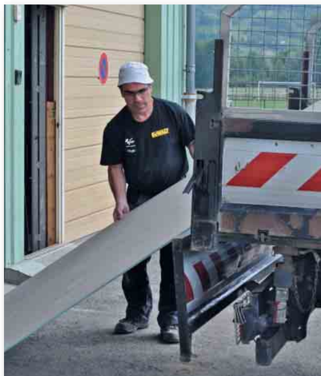
Travaux de rénovation du bureau, des vestiaires du service technique : coût estimé : 10 000 €
