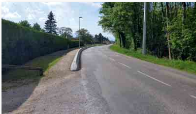
Remplacement des barrières bois par des bordures dites chasse-roues à la Papéterie (coût prévisionnel : 35 778 €)
